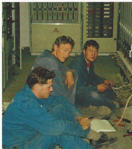
Kabling i tavlefelt, bygget etter Norzinks egne tegninger, i stoperiet. F.v. Jan Erik Fedje, Frode Moldekleiv, Jostein Hagen (Norzink)
