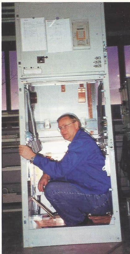
På «glattcelle» Gunnar Normann i en av cellene til Oslo Energi
