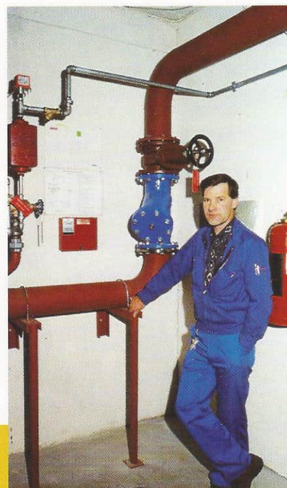
Trond Ivar Haug har driftsansvaret for sprinkleranlegget. Her ved stengeventilen i Elektrovarme-fabrikken.
