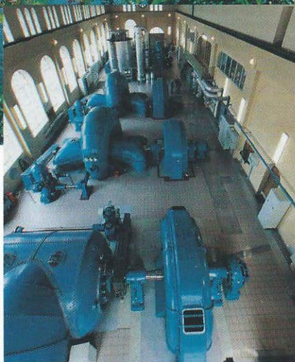
Maskinhallen i Nedre Leirfoss. Generator nr tre er Siemens, levert i 1958. Nr en og to er fra 1910, NEBB. Foto: Tore Wuttudal
