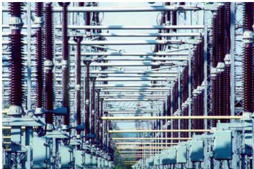
VIKTIG OPPDRAG: Siemens skal levere det første større luftisolerte koblingsanlegget for stamnettet i Norge på mange år.
