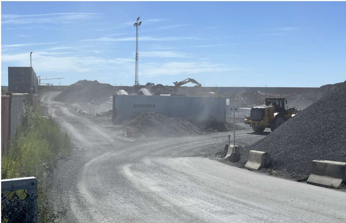
Figur 1 Sjenerende innsyn og støy langs kommunal vei, bildet er tatt fra John Strandruds vei inn til gbr. 41/893 og 41/894.
