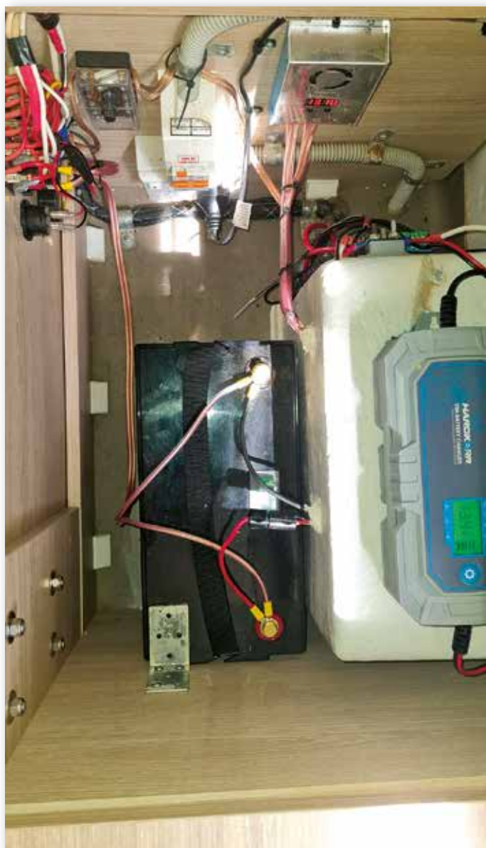
Ekstra innvendig montert batteri og på veggen i rommet der er solcelleregulator montert.
